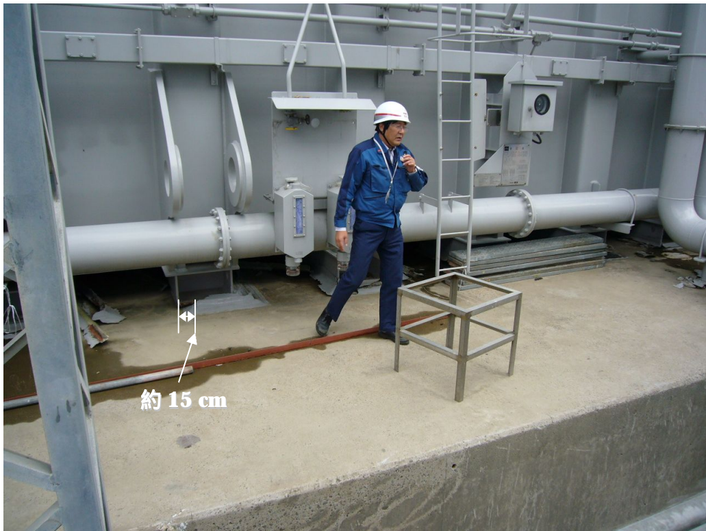
図 2.3 2号機主変圧器の横ずれ状況
