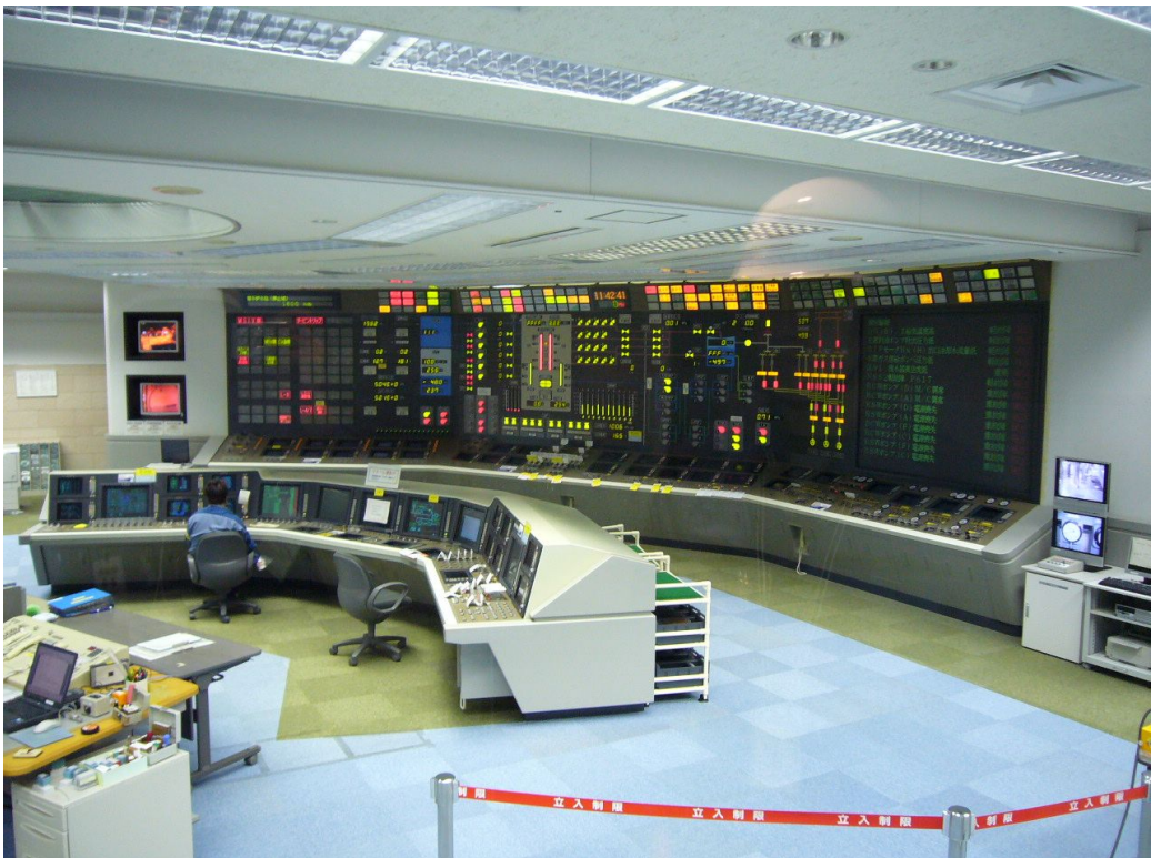
図 2.10 6/7号機中央制御室（6号機主制御盤） （ABWR）
