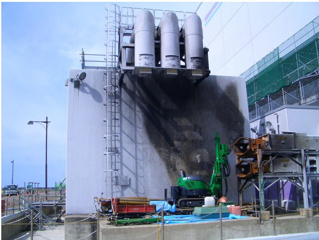
図 2.4 3号機所内変圧器火災跡(変圧器撤去後)
