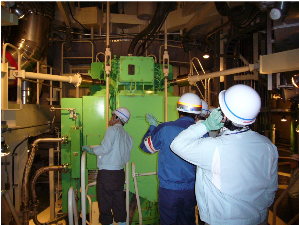
図 2.7 3号機原子炉再循環ポンプ および吊りハンガー/サポート
