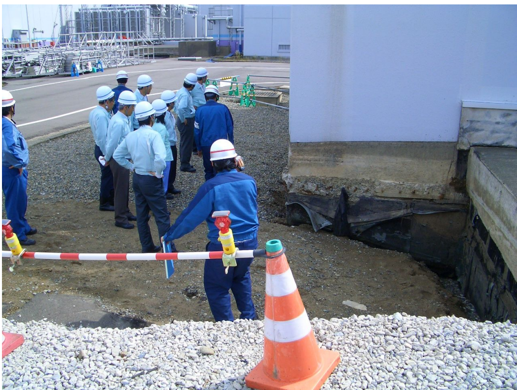
図 2.2 建屋周辺の地盤陥没状況
