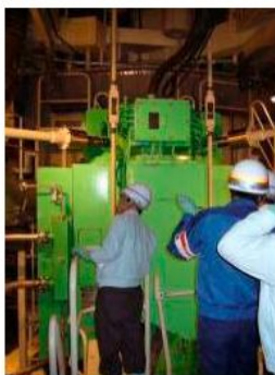
再循環系ポンプのモーターとスナッパなどのサポート
