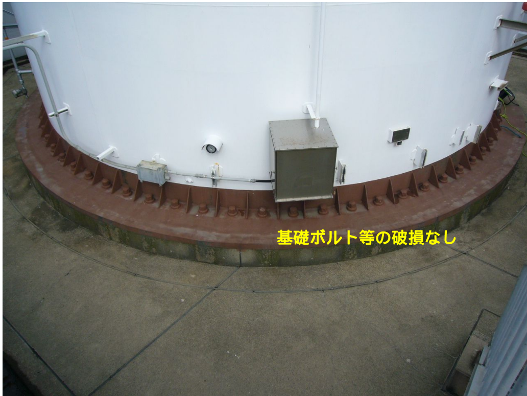
図 2.11 1号機軽油タンク (耐震Asクラス相当)
