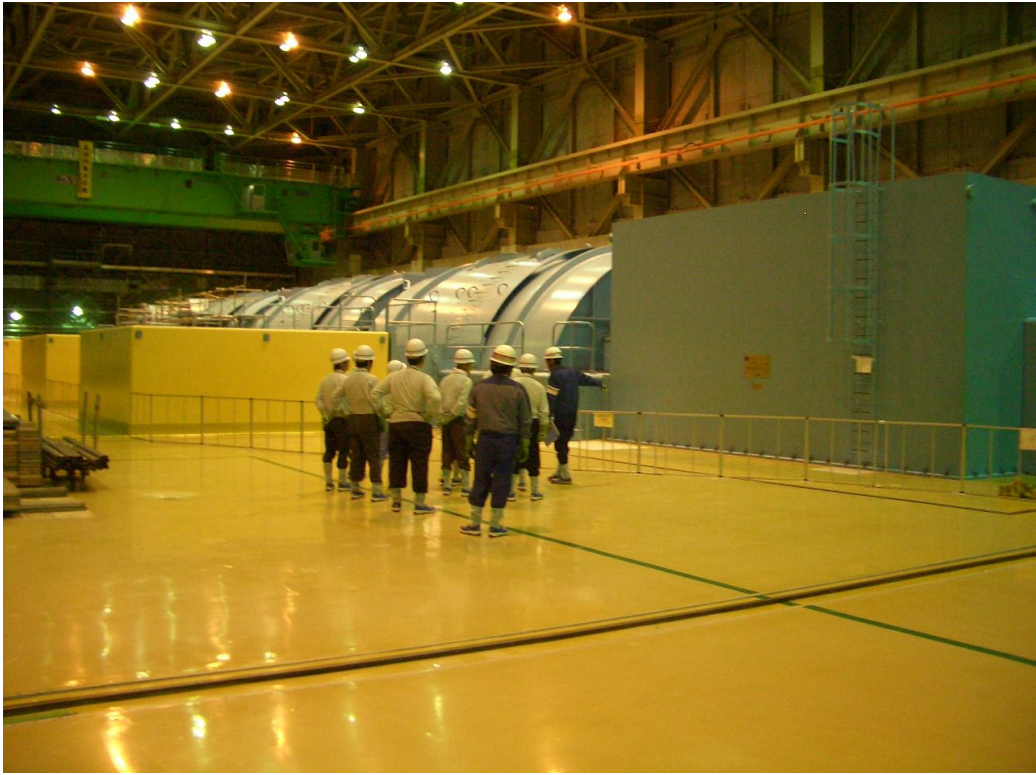
図 2.9 3号機蒸気タービン
