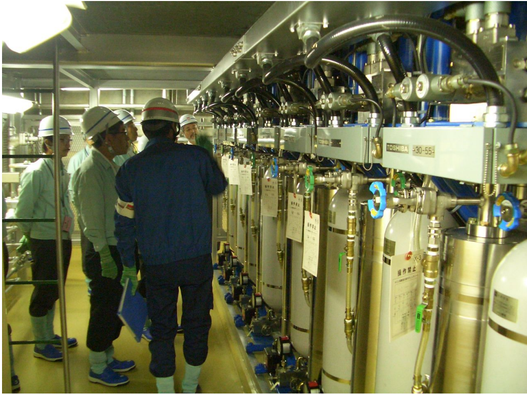
図 2.5 3号機制御棒駆動機構水圧制御ユニット
