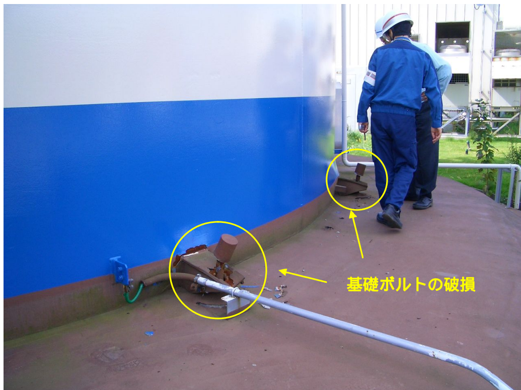
図 2.12 ろ過水タンク (耐震クラスなし)
