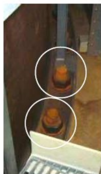
原子炉圧力容器ベDESTAL固定ボルト
