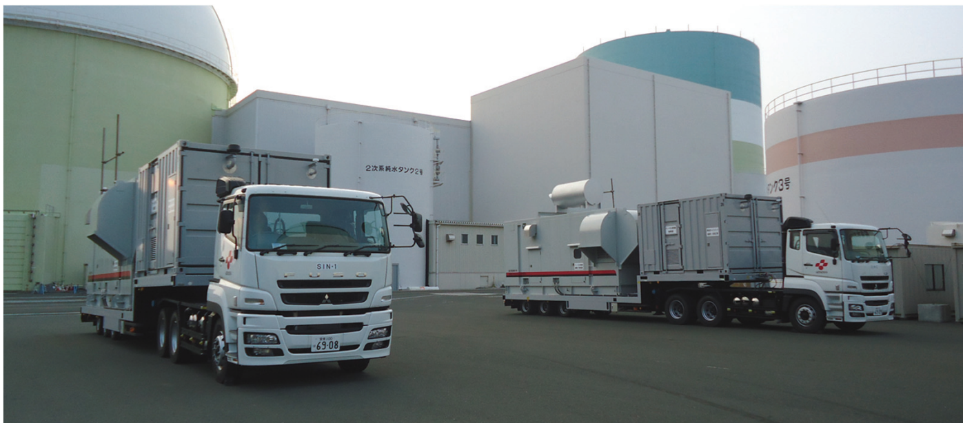
大容量電源車(1,825kVA)
