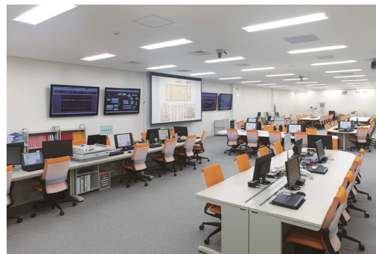
総合事務所2F 緊急時対策所
