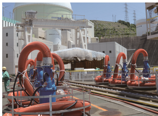
海水取水用水中ポンプ
