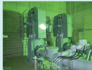
EWSポンプ(4号機)
