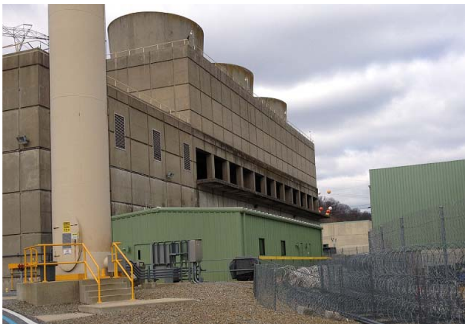
図-3 非常用ディーゼル発電機冷却水用クーリングタワー
