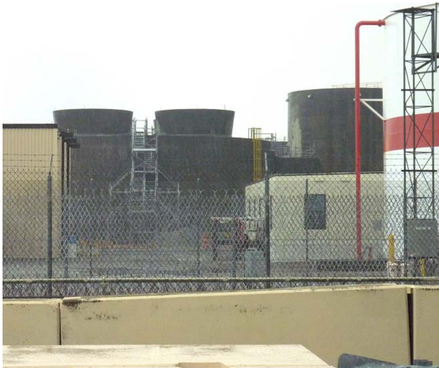
図-3 1,2号機の非常用クーリングタワー（左の2基）及びコンクリート製タンク（右の1基）
