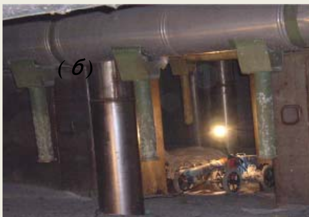
圧力制御プール-1の燃料含有物質堆積物(a)と 放射性エアロゾル遠隔サンプリング装置(b)
