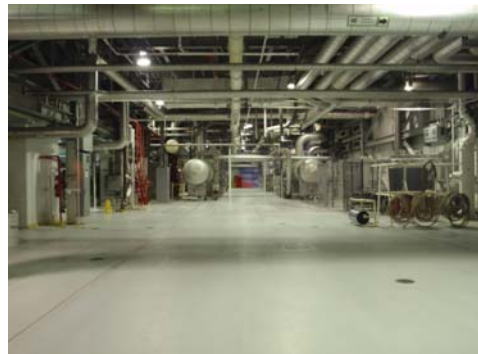
Fig 19 タービン建屋内部
