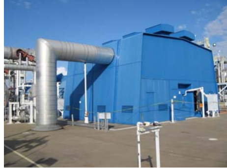
Fig 18 タービンデッキ③
