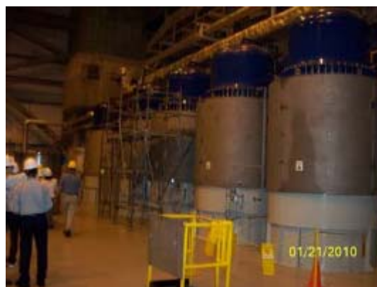
Fig.5.1 TB-123 Condensate Filters (手前から A,B,C,D 塔。C 塔に OLM 用足場が設置されている。)
