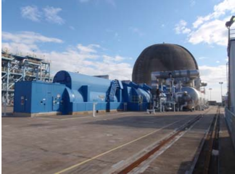
Fig 16 タービンデッキ①
