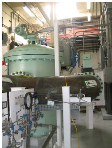
Fig 5.13 ECW ポンプ(据付状態)
