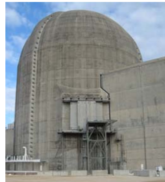
Fig 20 格納容器・機器搬入口
