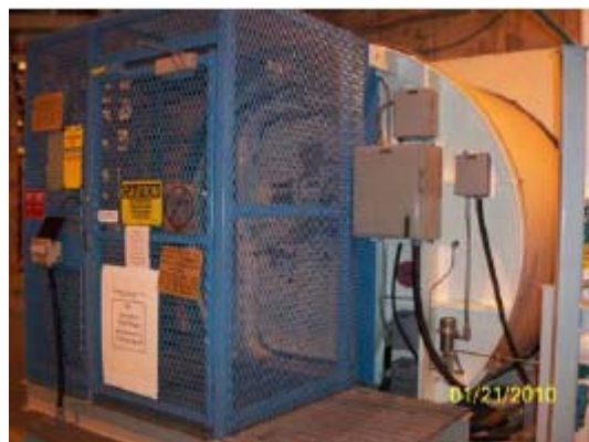
Fig.5.4 R/B Airlock Access (ケージ扉左側に ID カードリーダーが設置されている。)
