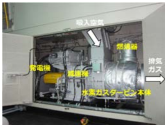
図3 水素 GT 発電装置
