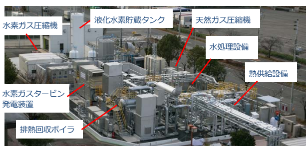
図 1 実証設備全景と機器配置
