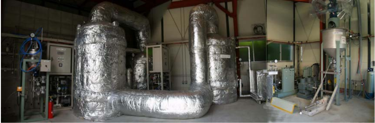
図1 1t/日超臨界水ガス化パイロットプラント
