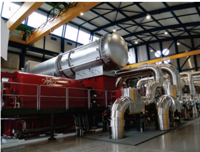
図3 スバルトセンギ地熱発電所6号機
