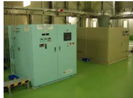
図7 水素発生装置
