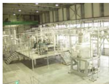
図2 30kW 海洋温度差発電実証装置
