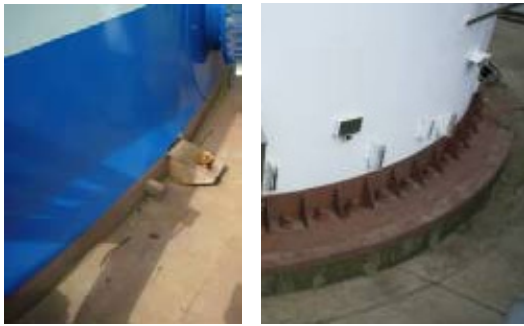
ろ過水タンク(クラス無) 軽油タンク(クラスA)
