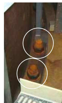
原子炉压力容器ペDESTAL固定ボルト
