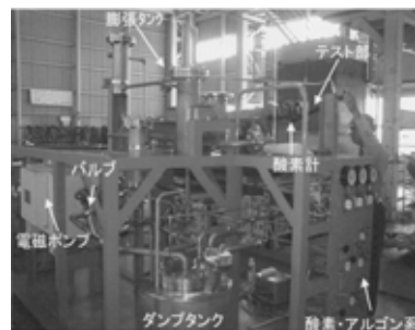
写真1 保温材設置前の鉛ビスマス循環ループ外観
