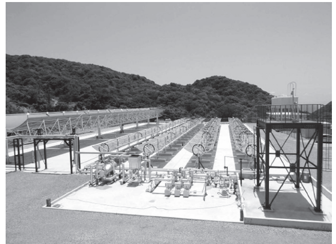
図3 太陽熱集熱装置（建設後）
