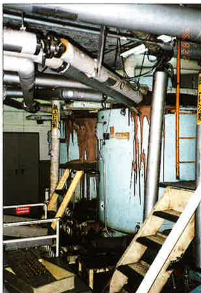
写真2 タンクからスロッシングにより溶けたチョコレートが噴出し、パイプは結合部で変形し、漏洩していた。
