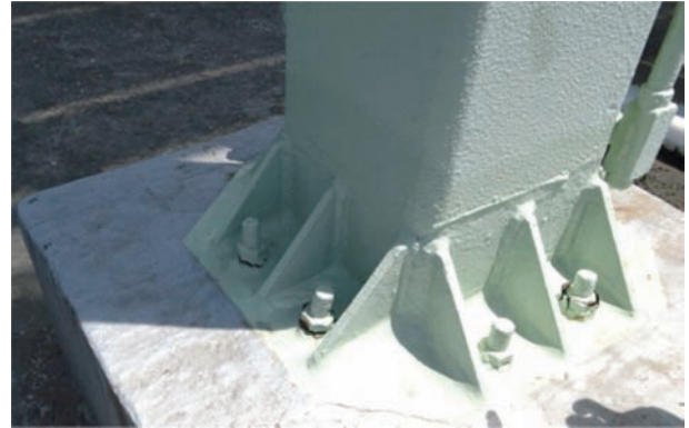
図5 基礎部沈下によるアンカーボルト
