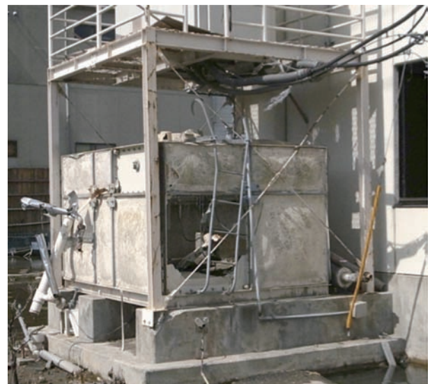
図4 FRP水槽の損傷
