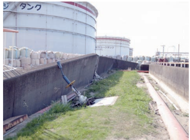
図6 太平洋沿岸地域での液状化による防油堤の傾斜被害 9)
