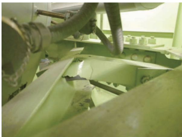
図1 ボイラ振れ止め部の損傷
