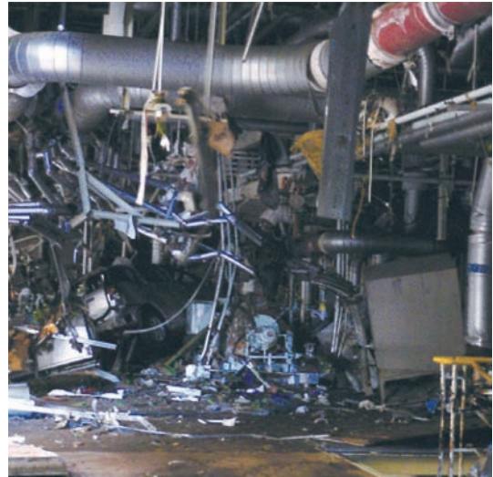
Fig.5 原町火力発電所タービン1Fフロアの様子 2)
