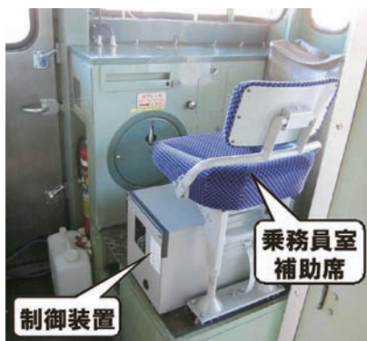
図10 制御装置設置状況
