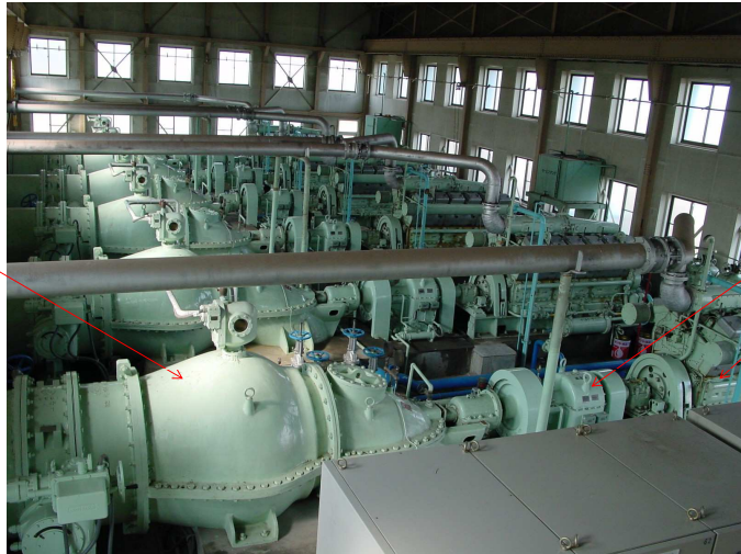
河川ポンプ設備(横軸斜流ポンプ)
