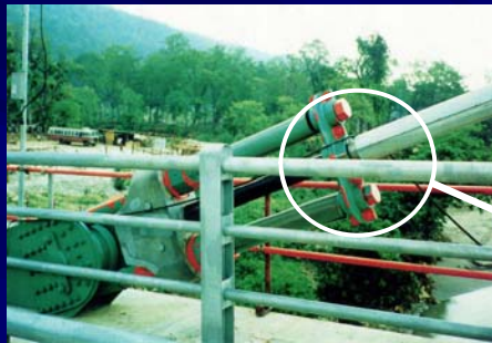
ケーブル支持部
